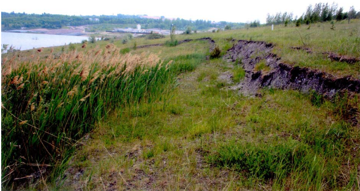
Abb. 2 Böschungsdeformation Muecheln (Westböschung), Blickrichtung Süd
